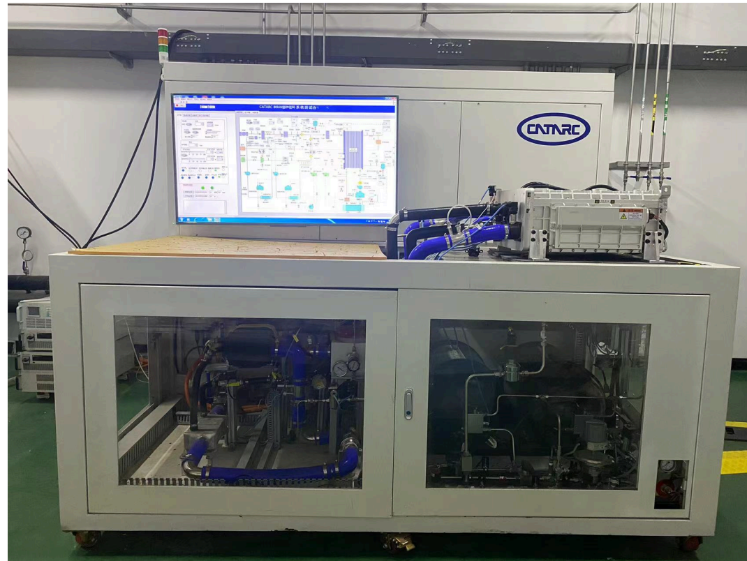
80 kW部件在环平台：真实车用部件与测控系统集成
