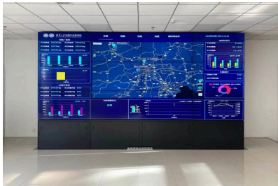
氢能监控平台·实物
